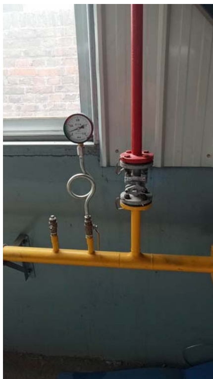
天然气泄漏报警装置
